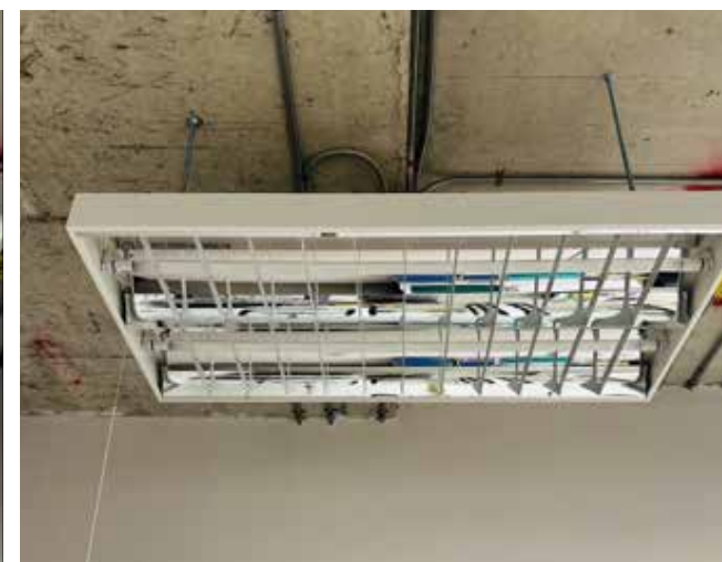
ทุกออฟฟิศมีเชือกดึงเพื่อควบคุมการเปิด-ปิดไฟ
